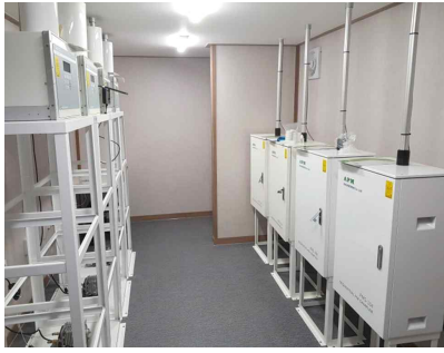
<시료채취장치 및 연속자동측정기>
